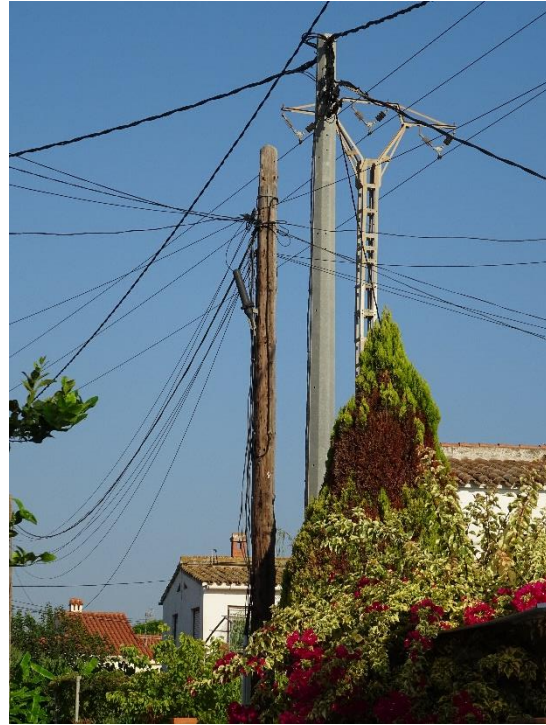
Imagen del estado actual del cableado. Fuente: elaboración propia
